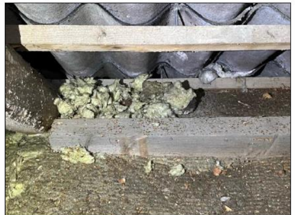
Ødelagt og "opgravet" isoleringsmateriale.
