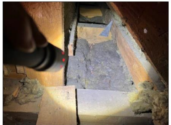
Igen et billede af "løbespor" i isoleringen.
