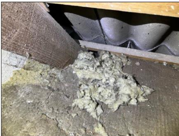
Ødelagt og "opgravet" isolering. Efterladenskaber
