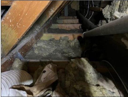
Billede ude fra skunken hvor det ses at der er nedtrådt isolering.
