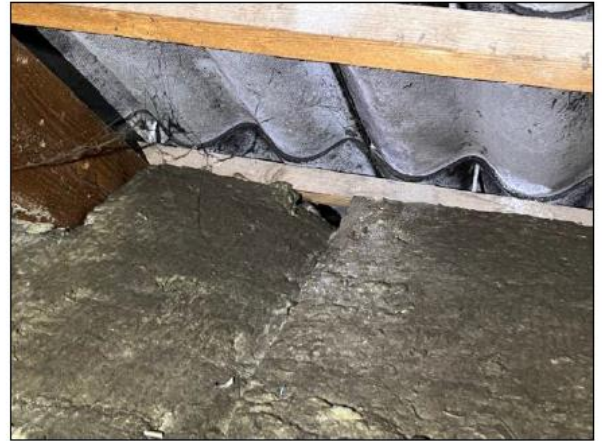
Billede af oversiden af isoleringen mod skråloftet, med tydeligt hul til gang.
