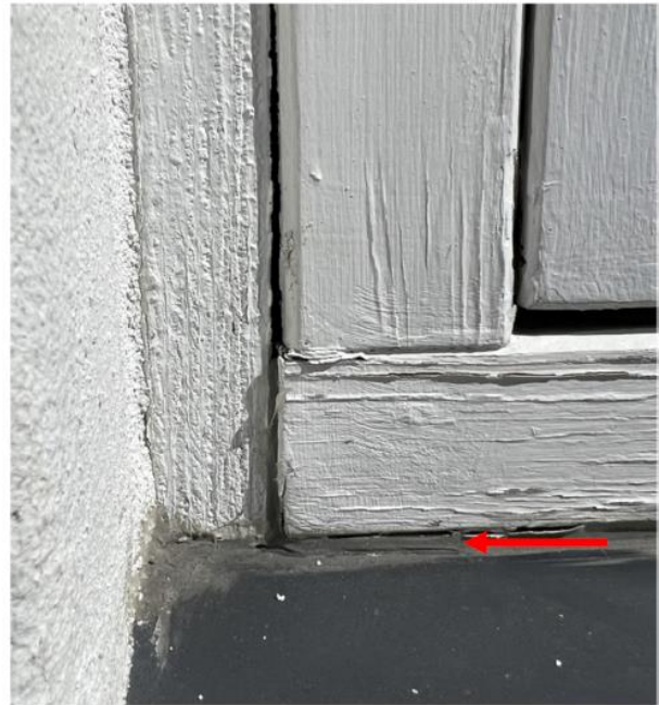
Vindue imod fals – Fuger er erstattet af trælister. I bunden af vinduet ses en elastisk fuge mod sålbænken i en højde på ca. 5 mm. Fugen ses slippe bundkarmen på vinduet.
