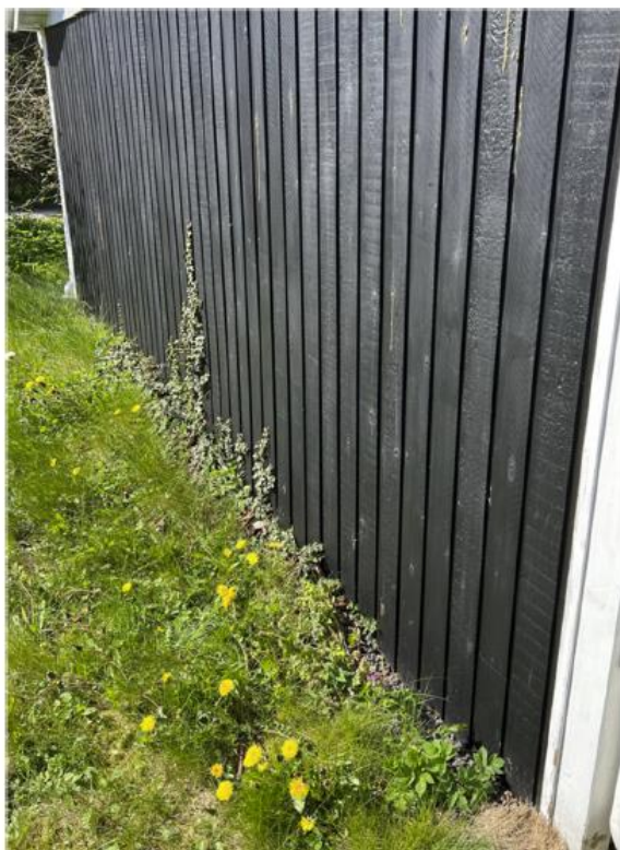
Gavl mod øst – beklædning slutte ses under terræn
