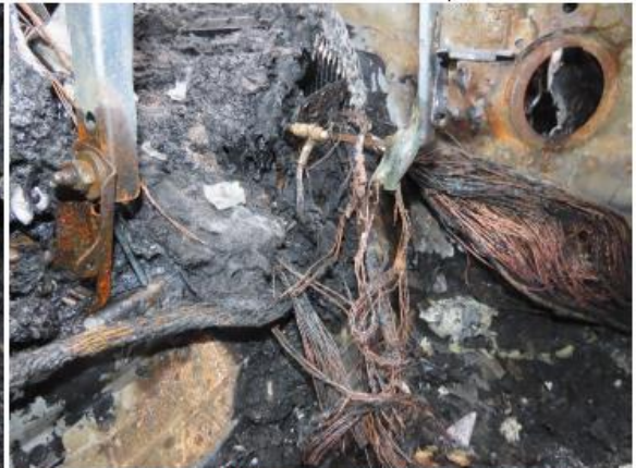
Foto 19 viser pluskabler til bilens elektriske varmeapparat.
