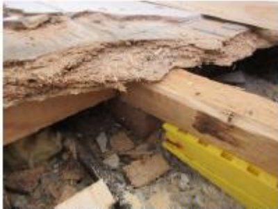
Tilfældigt samlede og opklodsede strøer.
