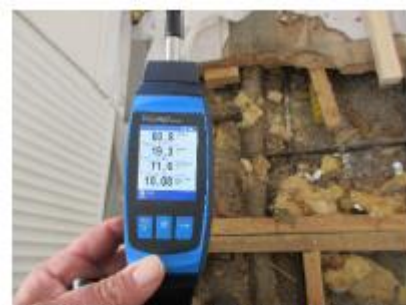
Luftfugtigheden er 60,8 % RF (høj)
