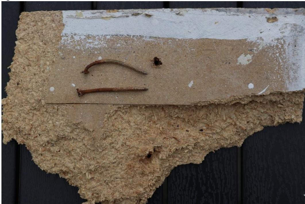
Rustne søm udtrukket af gulvspånplade
