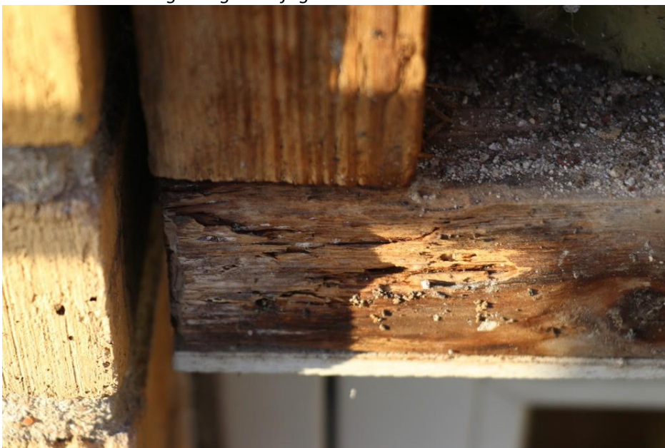
Råddent træværk og manglende fuge
