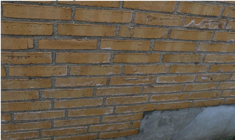
Opfugtning af sokkel nær hullet i bagmuren
