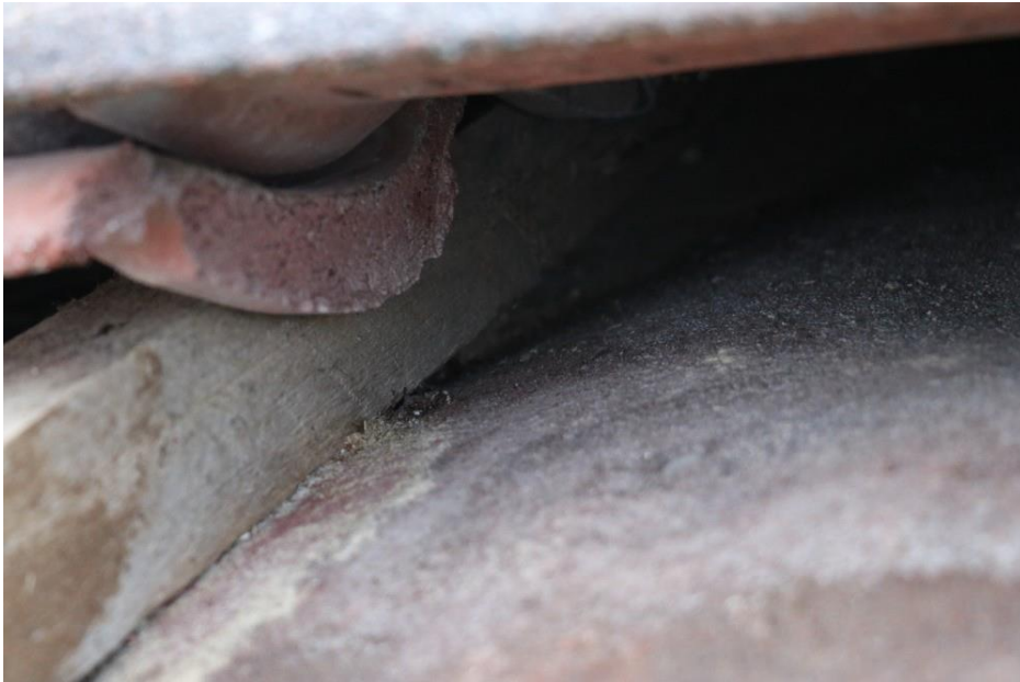
Manglende afstandsstykker mellem lægter og tagpladeunderlag
