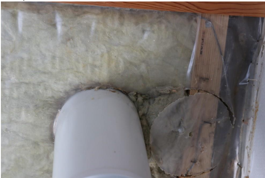
Hul i dampspærre og manglende isolering i bryggersloft
