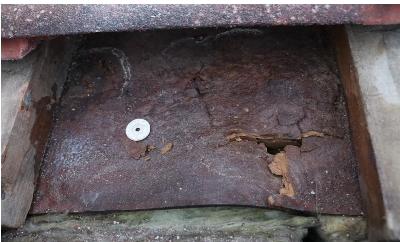
Stærkt beskadiget tagpladeunderlag
