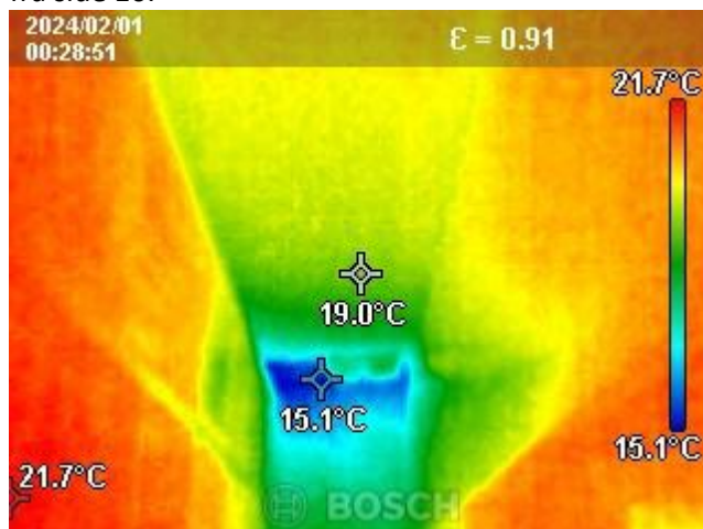
Termografi af det kolde gulv i stuens nordøstlige hjørne
