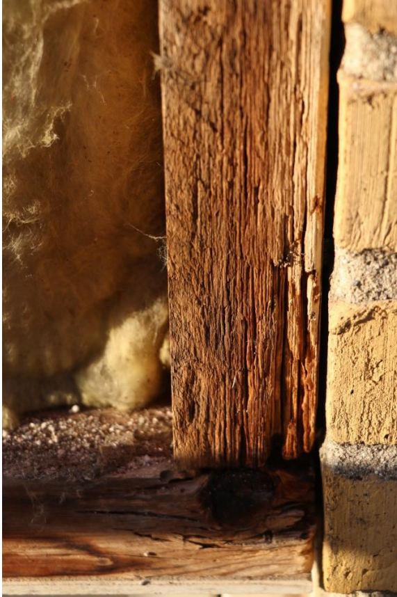
Råddent træværk og manglende fuge
