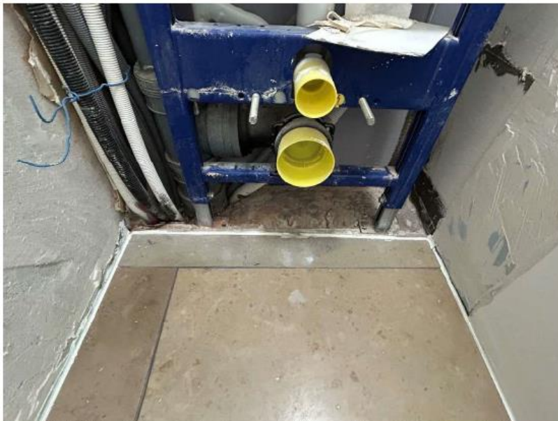
Foto 1: Under indbygningscisternen kan det ses at der ikke er etableret vådrumssikring af gulv og væg.
