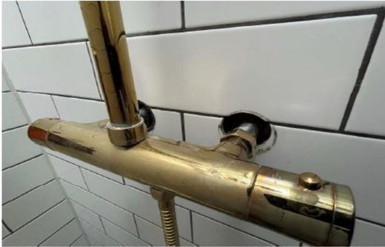
Foto 1: Der ses ingen koblingsdåse eller anden form for tætning omkring rørgennemføringer i vådzone. Der er nærliggende risiko for at vand fra bruser vil kunne trænge ind i vægkonstruktionen omkring de to rørgennemføringer i brusenichens ene væg.
