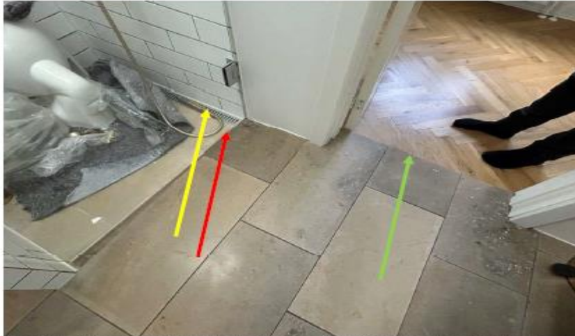
Foto 1: Gul pil viser gulvaflejb. Rød pil viser opkant på ca. 10mm. Grøn pil viser manglende tærskel.
