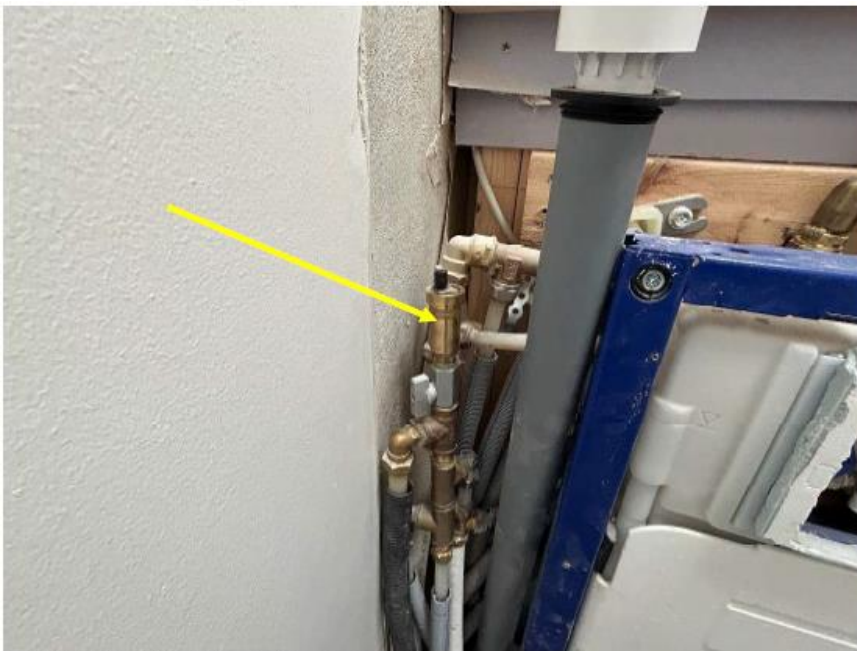
Foto 2: Udskiftet luftudlader markeret med gul pil.
