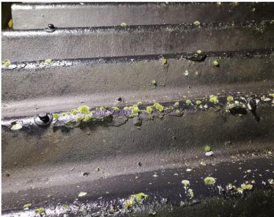
Kraftig nedbrydning af tagplader på tilbygningen
