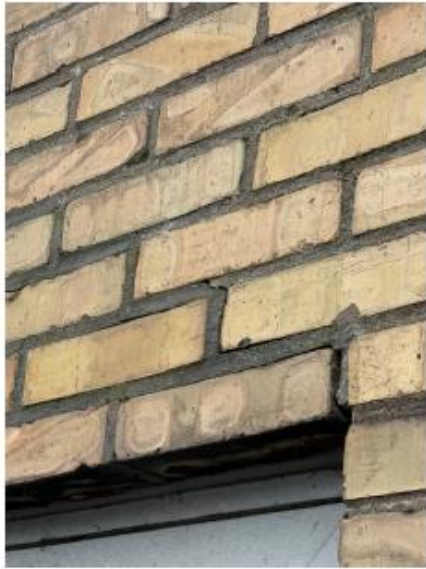
3 revner og udfaldne fuger
