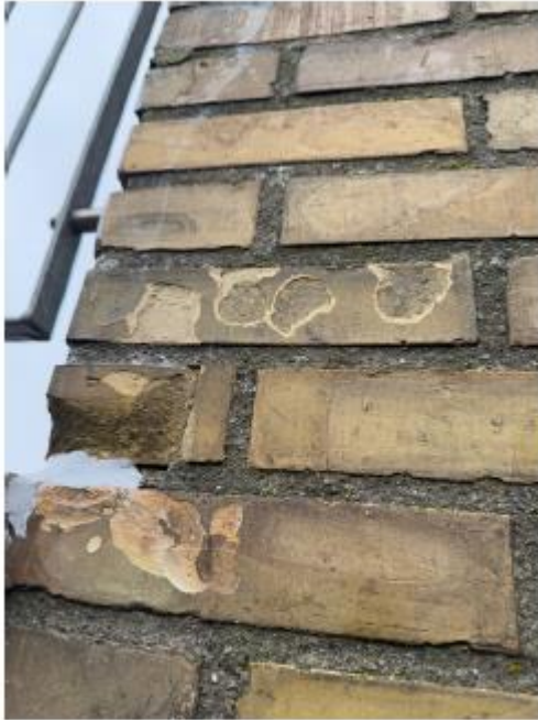
7 afskalninger på mursten
