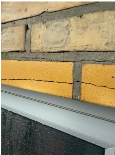
5 revne i overligger og fuger
