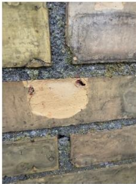
6 afskalninger på mursten
