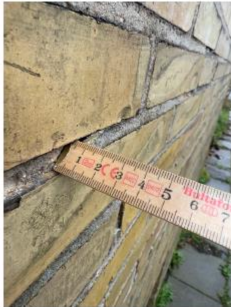
8 måling af dybde på fuge = 6 mm
