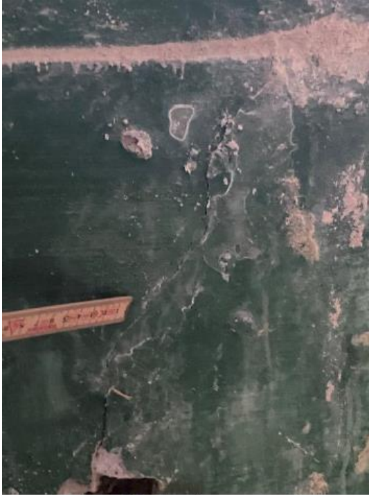
Revne i kælderydervæg – nr. 3
