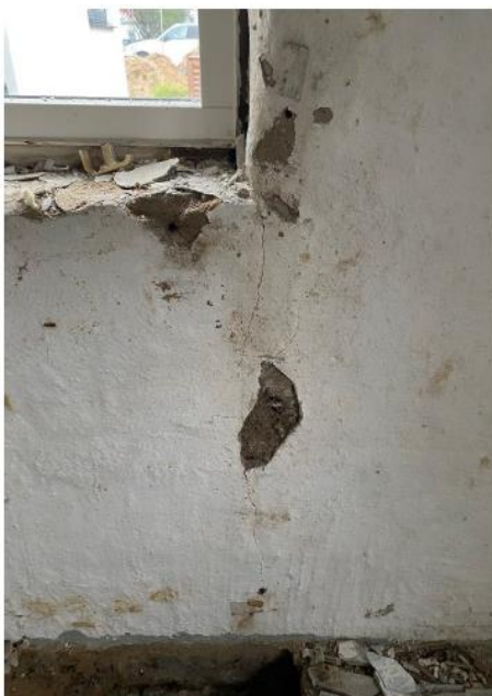
Revner i kælderydervæg – nr. 1
