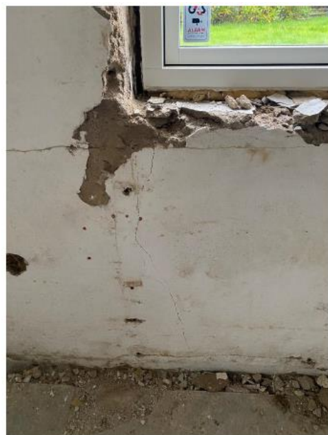
Revne i kælderydervæg – nr. 2
