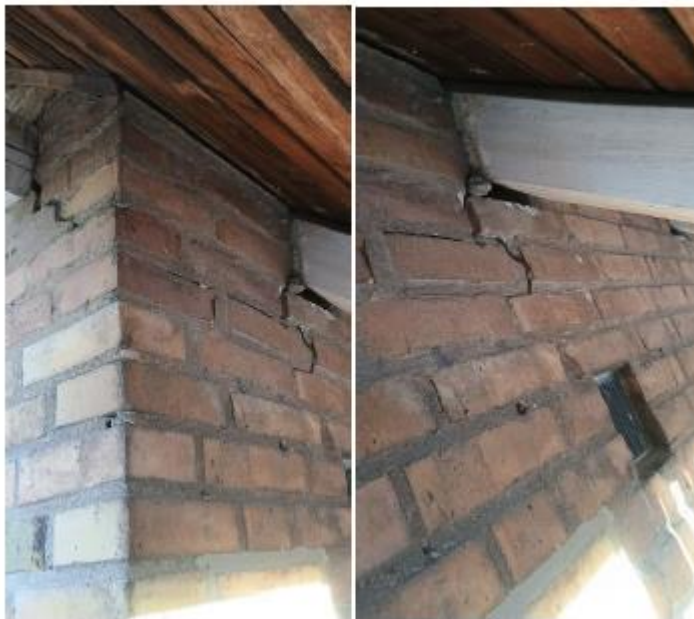
Billede 7 – Revner i i nordgavl der forplanter sig ud i facaden mod [vej]
