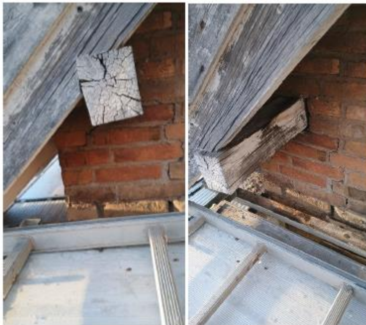
Billede 5 – Sydgavl – Drejning af rem samt revner i murværk mod [vej]
