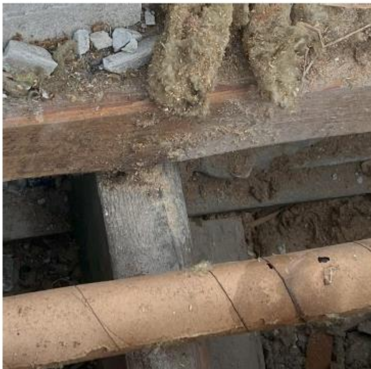
Billede 9 – åbning mellem tidligere spærfod og rem indikere en tapsamling
