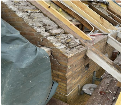
Figure 4: Vestfacaden mod Irisvej med tydelig vridning af rem og skader i murværket.
