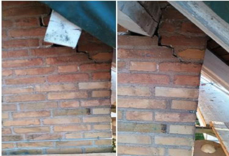
Billede 6 – Nordgavl – Drejning af rem samt revner og drejning i murværk mod [vej]
