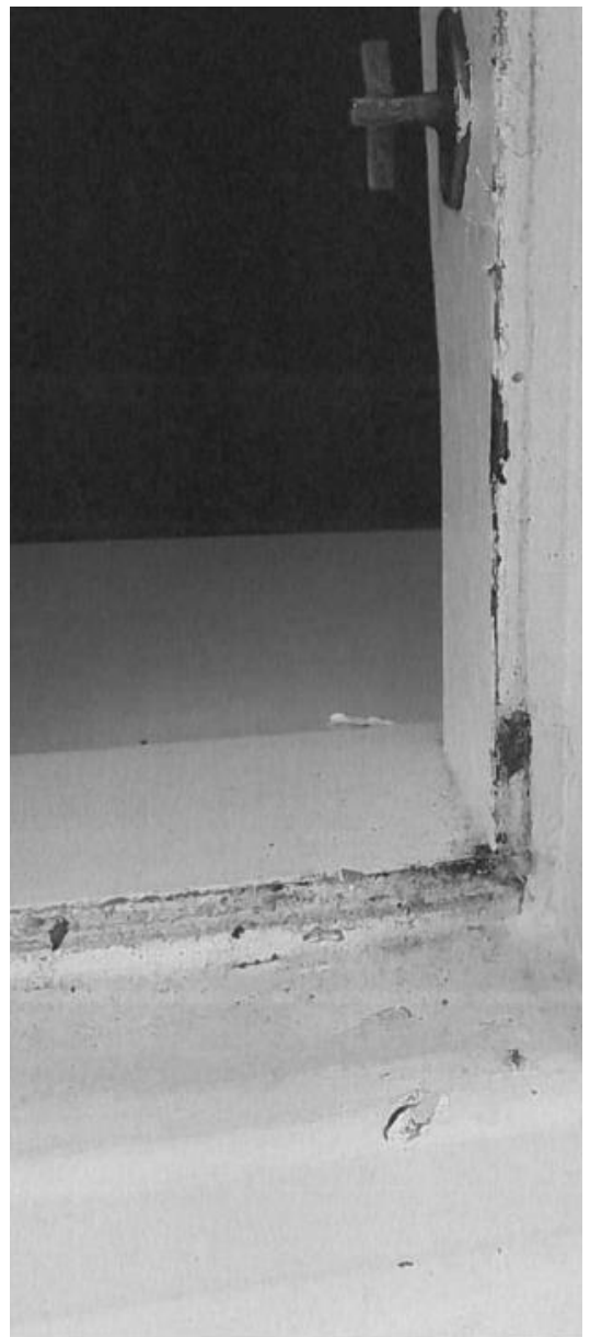
Anlægsmærke på vindue.
