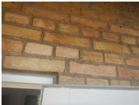
Fortandning revne ved terrassedøren
