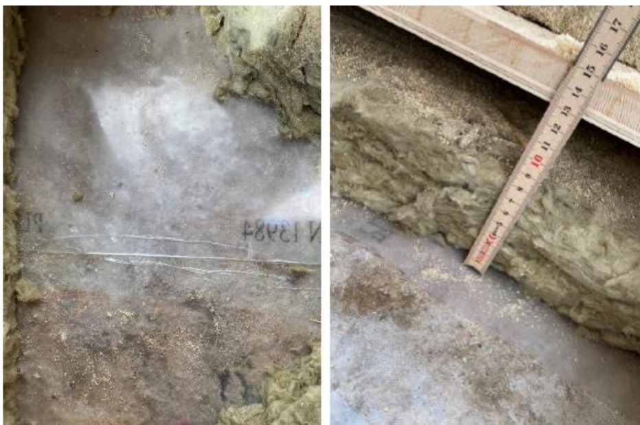
Plastfolie som fugtspærre, synlige misfarvninger under folien
