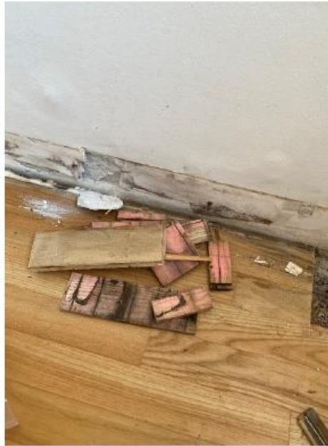
Fugtskadet gulv med synlig forekomst af skimmelsvamp
