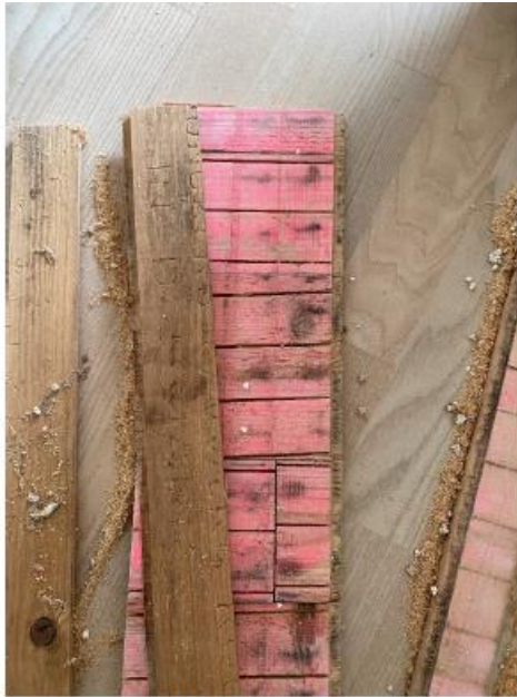
Fugtskadet gulv med synlig forekomst af skimmelsvamp
