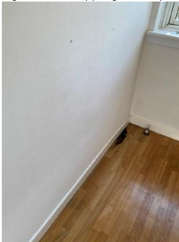
Synlig misfarvning af gulv
