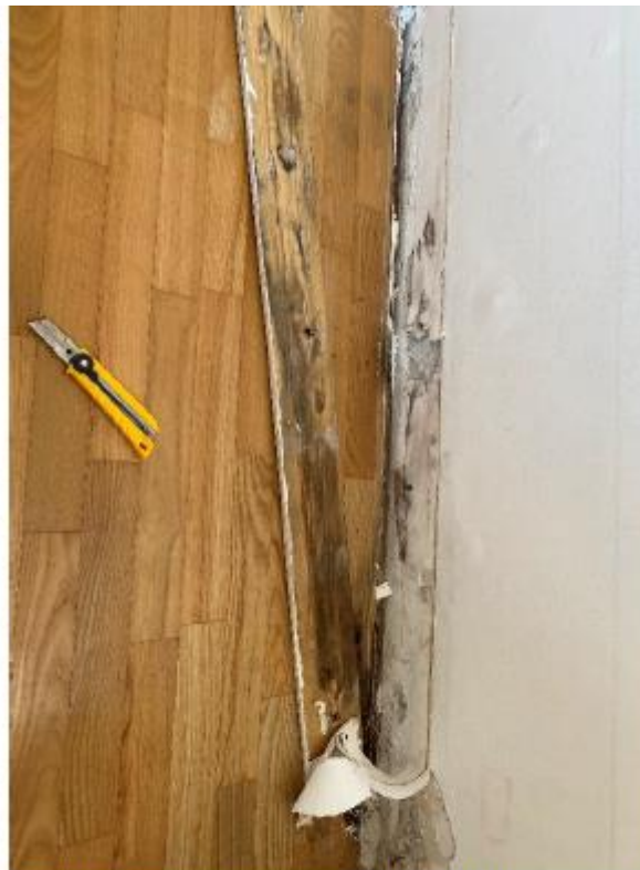
Synlig misfarvning på bagside af fodpanel
