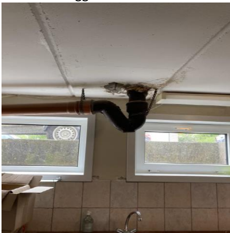
I det underliggende kælderrum er vandlåsen synlig
