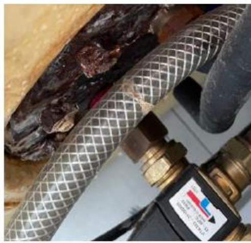
Figur 2 - 2022-foto: Markante, hvide kalkaflejringer på slange og fittings under bundpladen.
