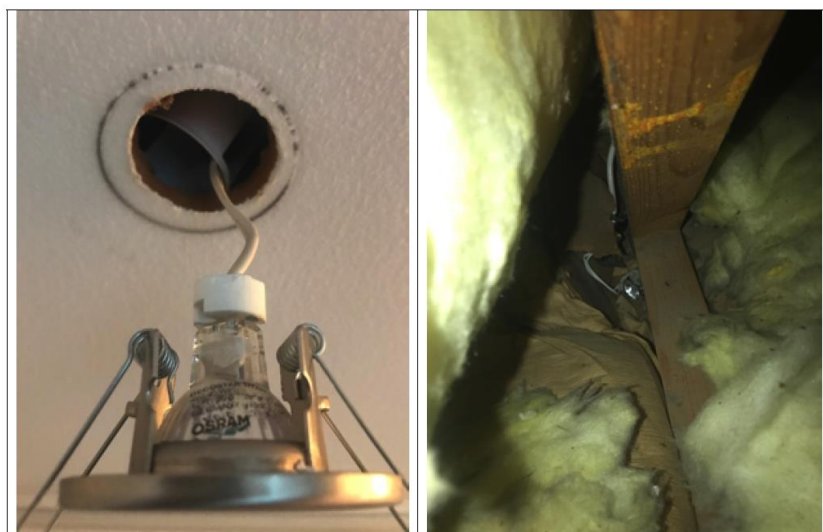
D01-F1 Fejlmontering af belysningsarmaturer
