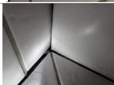
Elastiske fuger i hjørne samling er fjernet. Der ses mindre revne i elementsamling i hjørne.
