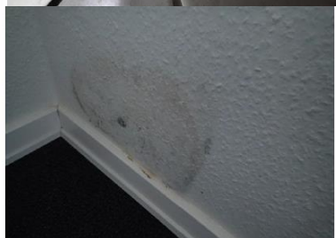
På væg i værelse (3), bag bruseniche, væg uden brusearmatur, ses indtørret fugtplamage.
