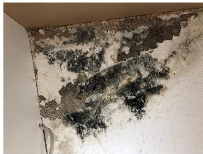
Billede 3. Fugtskaden tæt på
