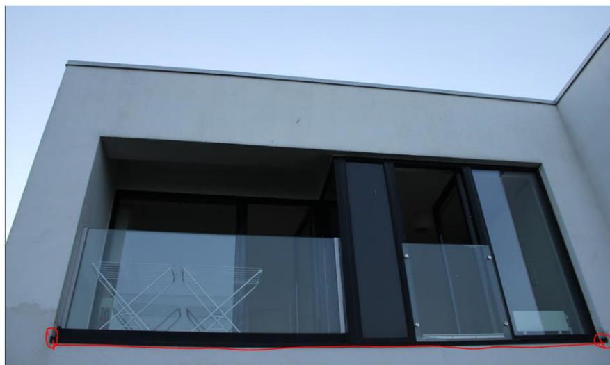
Figure 5: Cirklér viser area , hvor tilstandsrapporten har kommentar, lige linjen langs sålbænksprofil skal tættes og er ikke nævnt.
