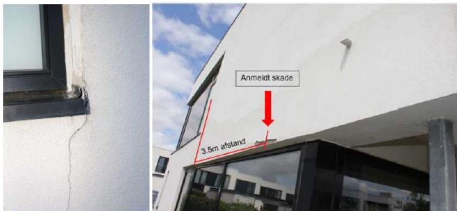
Figur 2: Til venstre – Lodret revne ved sålbænk på ovenfor køkkenvindue. Til højre – Anmeldt pudsskade vidst med afstand fra kant af sålbænk.
