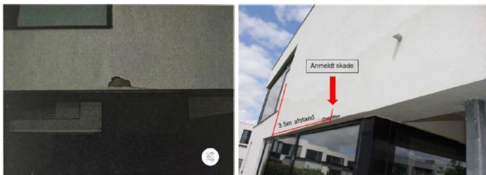
Figur 1: Til venstre – Foto af et andet hus fra [redacted] notat angående pudsskader. Til højre – Foto af vores hus – pudsskade afstand fra sålbænk.
