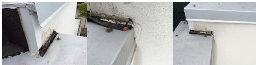
Fotos angiver murkrone / sternkant med forsøg på udførelse af inddækning
