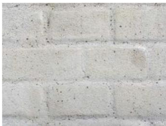
Revner i murværk
