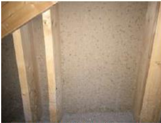
Skimmel på Bagside af vindgipsplade – gavl mod øst
