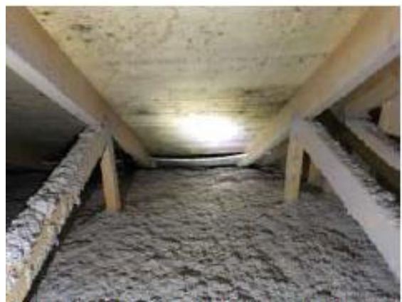
Skimmel på underside af x-finer – ved gavl mod øst
