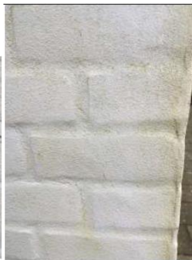
Revner i murværk
