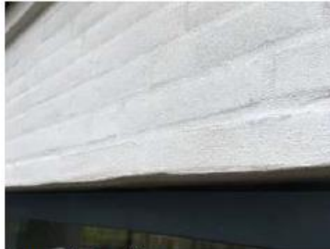
Revne ved tegloverligger
