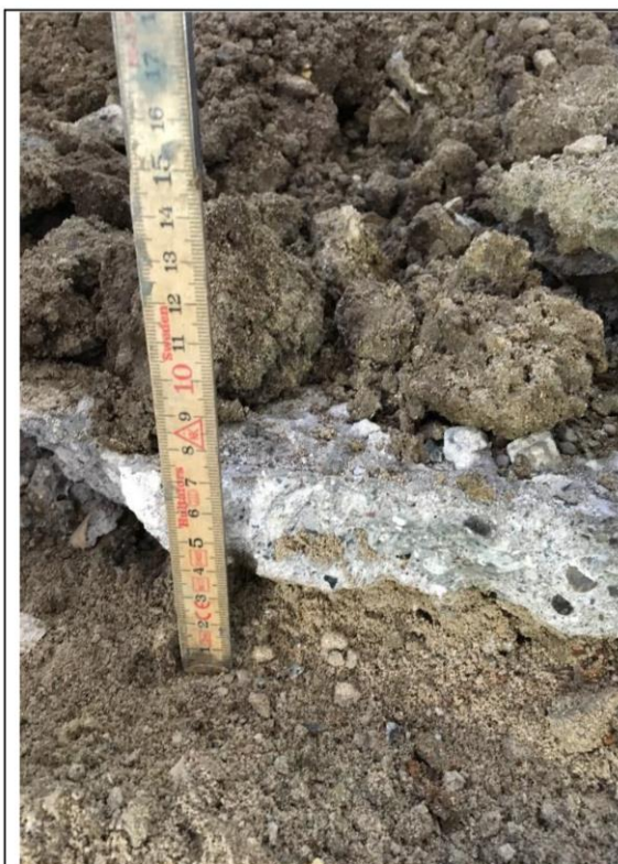
Klaplag i køkkenet tyndt, af dårlig kvalitet og uden plastfugtspærre
