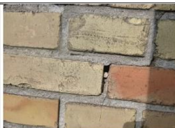
Foto 28 - Manglende fuger på gavl fra nr. 8 mod nr. 6 mod have.
