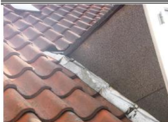
Foto 37 - utilstrækkelig overlapning eller inddækning langs skæringen under kvisttag.
