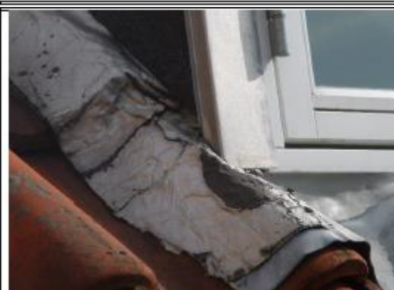
Foto 38 - Flere gange interimistiske reparationer af inddækninger omkring kvist.
