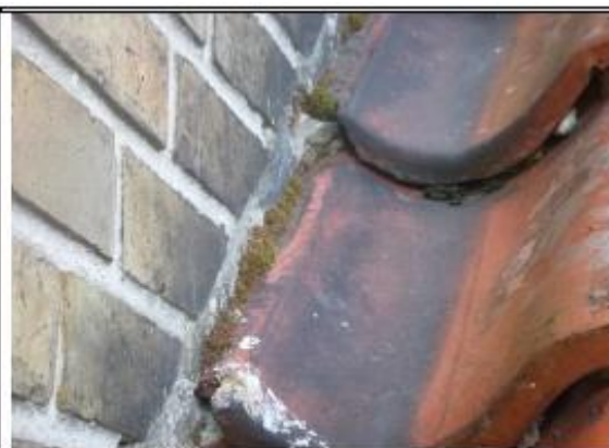
Foto 18 - Sporadisk defekt og nedbrudt forskelling ved øvrige sammenbygninger mellem gavlmure og taadækninaer.
