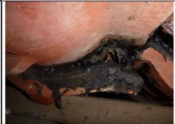
Foto 56 - Den udførte understrygning fremstår mangelfuld og med mange huller.
