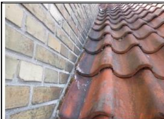
Foto 17 - Sporadisk defekt og nedbrudt forskelling ved øvrige sammenbygninger mellem gavlmure og taadækninaer.
