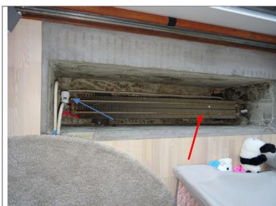
1. Rød pil = radiator – Blå pil = radiatorventil
