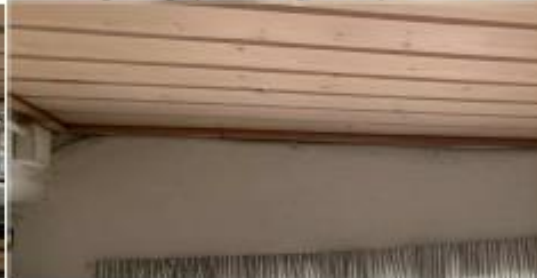
ingen tegn på sætning, kabel plan med loft
