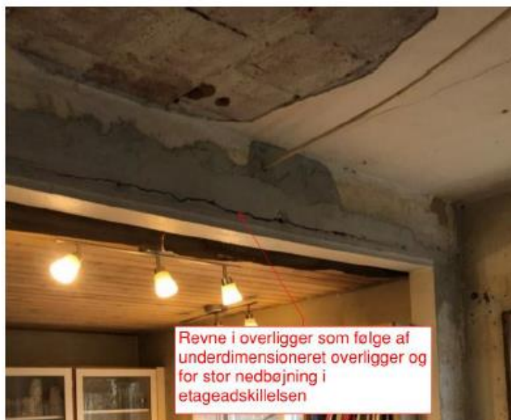
Foto nr 3. Der ses tydelige revner i overligger.
