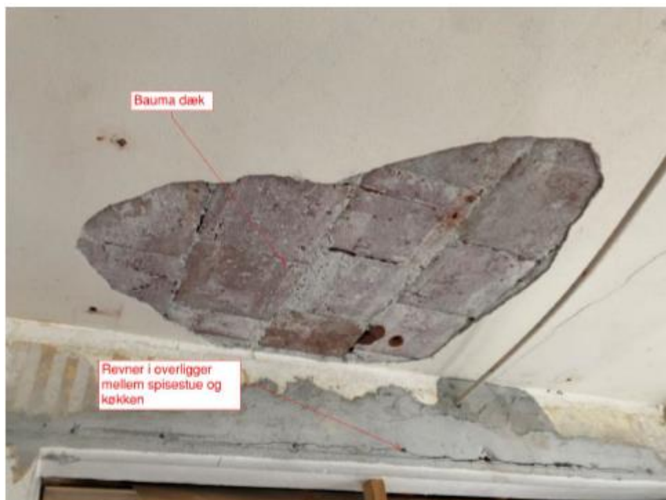
Foto nr. 1 viser hulstendæk og bærende væg som understøtter dækket mellem køkken og spisestue. Der ses omfattende revner som måles til større end 5 mm.
