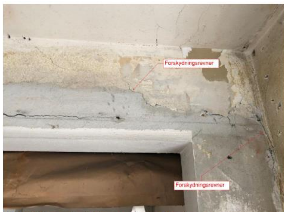
Foto nr. 2. Der ses forskydningsrevner ud mod facade væg.
