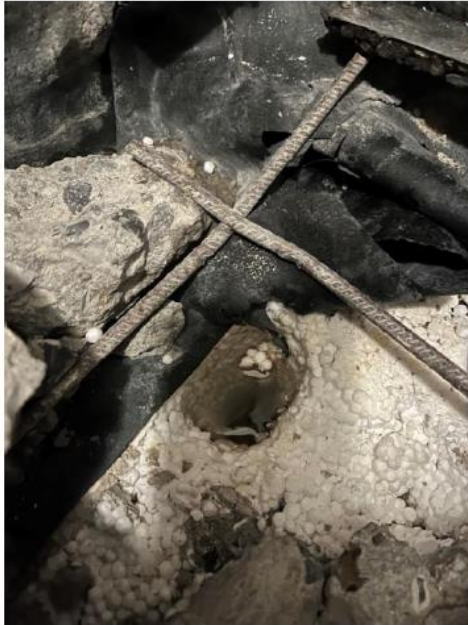
Figur 1 Foto af gennembrudt gulv med polystyren under og vandspejl næsten op til underside af betongulv. (Bilag L)
