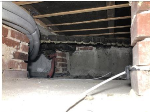
Uisolert krybekælder under gangareal.
