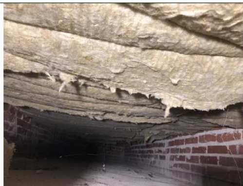
Isoleret krybekælder under værelser. Sokkel ventiler ar afblændet af isoleringen
